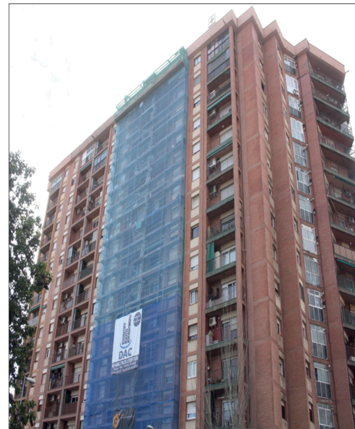
Hi ha moltes possibilitats per a la rehabilitació d'edificis, una de les que dóna més bon resultat és la instal·lació d'ascensors ja que es millora molt la qualitat de vida de tota la comunitat de veïns
